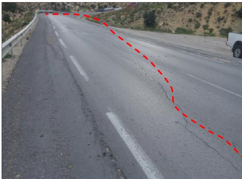
Figure 2. État de la chaussée dégradée
