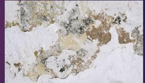
Dégradation du revêtement.
