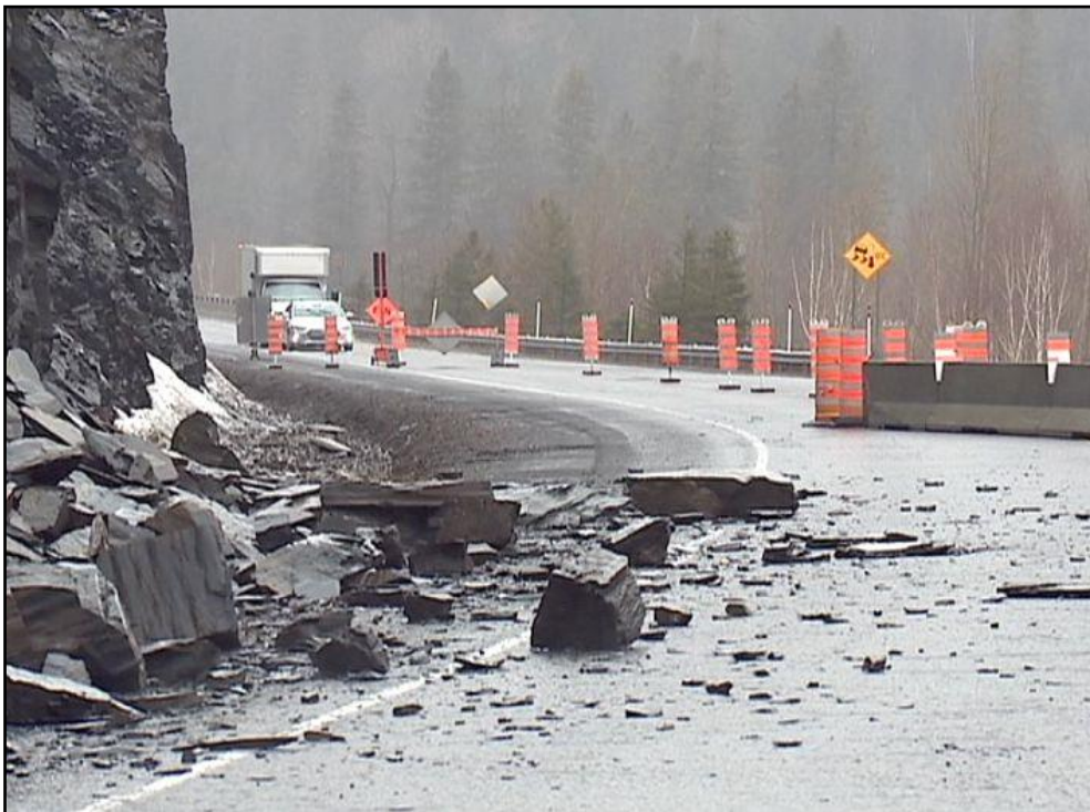
Figure 28. Éboulements à Routhierville.
