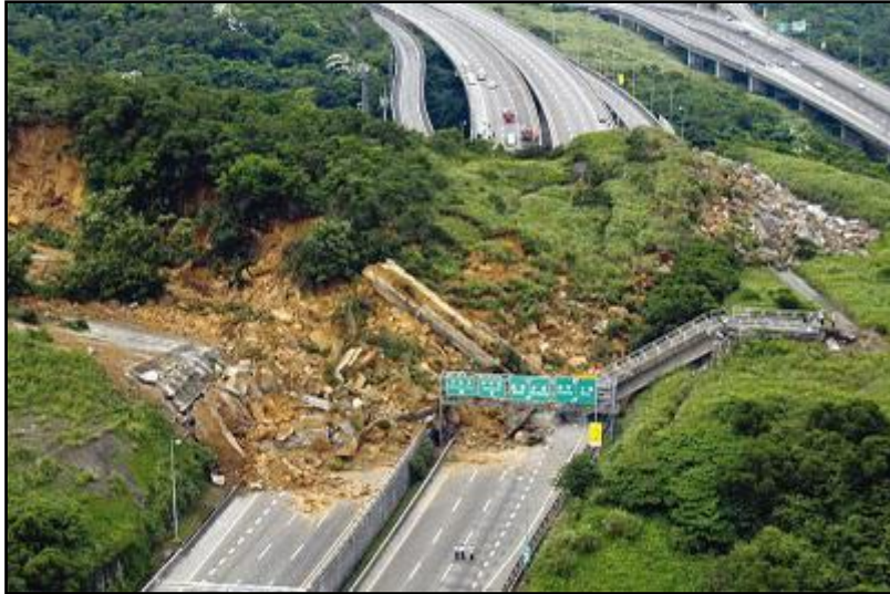
Figure 29. Glissement de terrain sur l'autoroute n°3 entre Keelung et Taipei.
